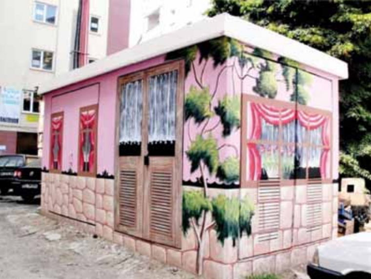
Şekil 5. Trafo binası (www.fatsabelediyesi.com).
