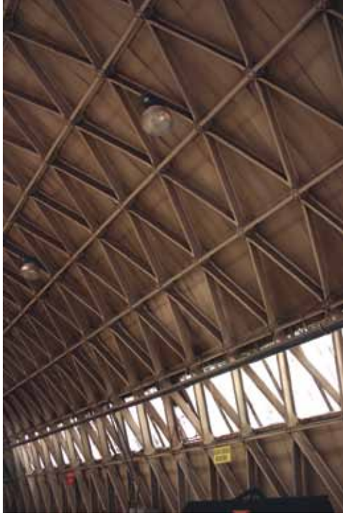
Şekil 4. Kayseri Uçak Fabrikası Hangarları Çelik Taşıyıcı Sistemi.
