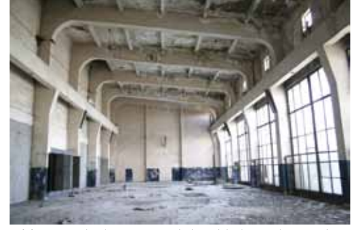
Şekil 12. Sümerbank Kayseri Bez Fabrikası Elektrik Santrali Pano Odası.
