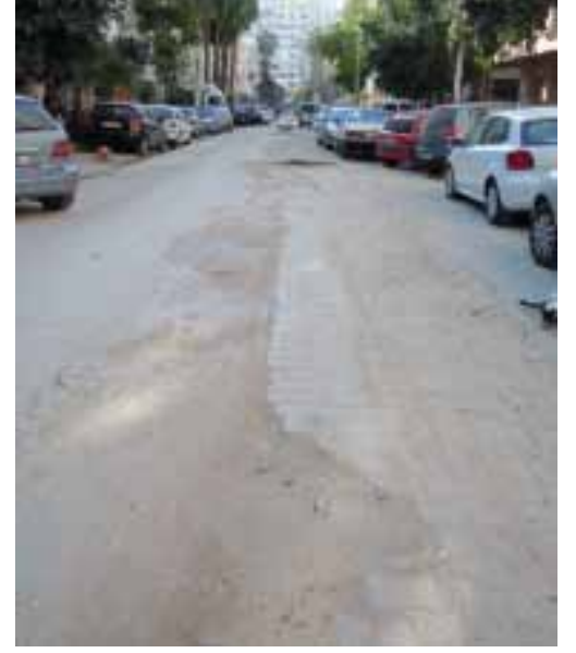
Resim 4. Kurtuluş Mahallesi alt yapı çalışması sonrası bozulan yollar (S. Çerçi).
