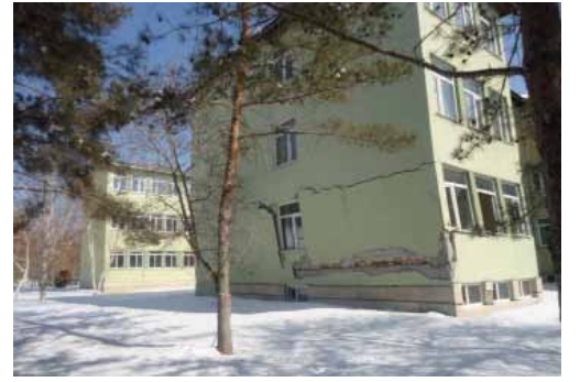
Ağır hasarlı DSL yönetim binası.
