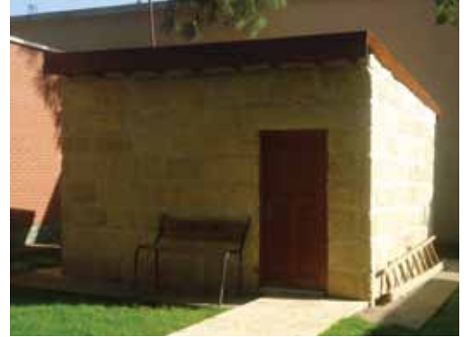
Resim 9. Müştemilat Onarım Sonrası
