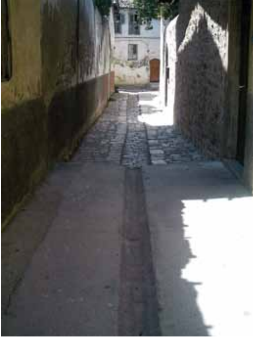
Resim 2. Antakya'da taş sokak döşemelerinin betonla kaplanması (Fotoğraf: Duygu Saban Ökesli)
